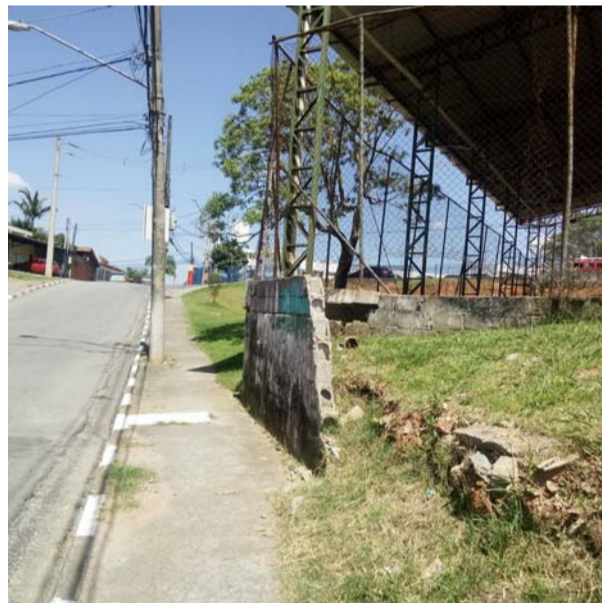
Estas fotos são da Escola Municipal Francisca do Prado, que vemos toda desmantelada.
