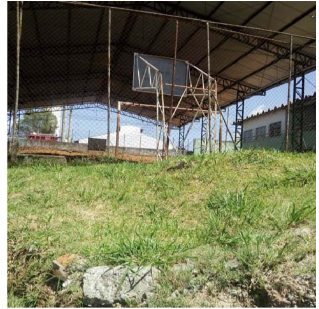
Muretas quebradas há algum tempo, vemos também a armação da tabela de esporte toda enferrujada.
