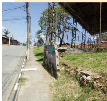
Estas fotos são da Escola Municipal Francisca do Prado, que vemos toda desmantelada.
